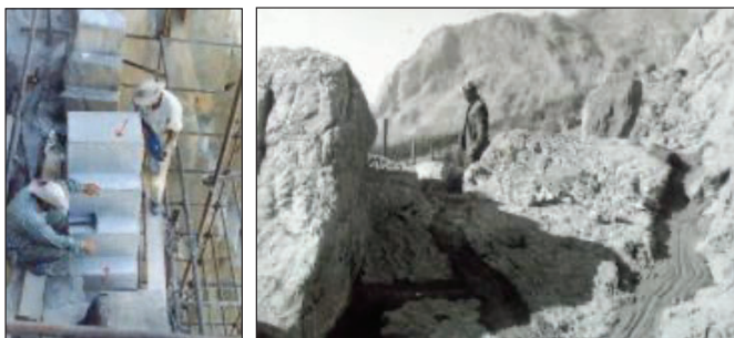
شکل ۱۰. الف. پر کردن شکاف‌های بالای تاق با سیمان در سال ۱۳۵۶ (مرکز اسناد پژوهشگاه میراث فرهنگی و گردشگری، ۱۳۵۶) ب. تعویض کنگره‌های تاق بزرگ در سال ۱۳۷۲ (مرکز اسناد پژوهشگاه میراث فرهنگی و گردشگری، ۱۳۷۲)
